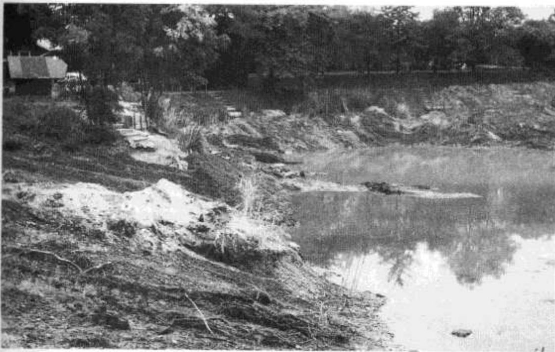
Bild 11 Rampen mußten an der Böschung angelegt werden, damit die schweren Geräte bzw. Baumaschinen auf die tiefer liegende Seefläche fahren konnten.
